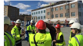
Det jagår flera om och nybyggnationen av skolor i Uppsala, bland annat har Tundaskolan rivits. Där byggs det en ny skola. FOTO: SVT
